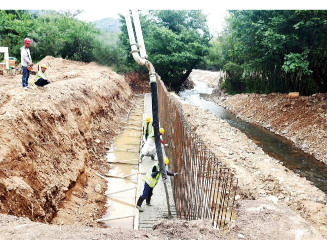
5月6日,位于郎溪县姚村镇的响龙峡漂流项目施工现场正在实施基础工程。该项目建设点位于姚村镇姚泉村,漂流长度约4.1千米,落差约55米。项目竣工后,姚村镇再添新景点,进一步丰富旅游业态。 特约记者 王祖清 摄
