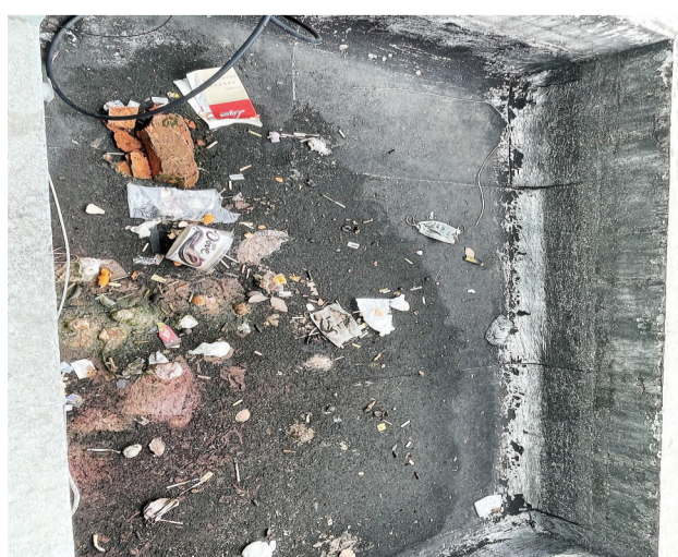
丽景嘉园3#1单元2楼楼层平台有垃圾。
