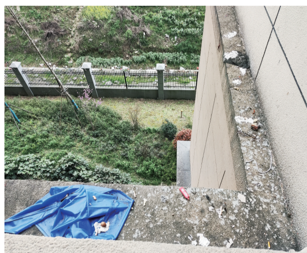
滨江花园13幢3楼房檐存垃圾。
