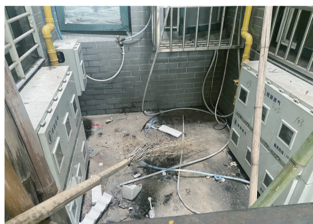
城东新村12#1单元1楼平台乱有垃圾。
