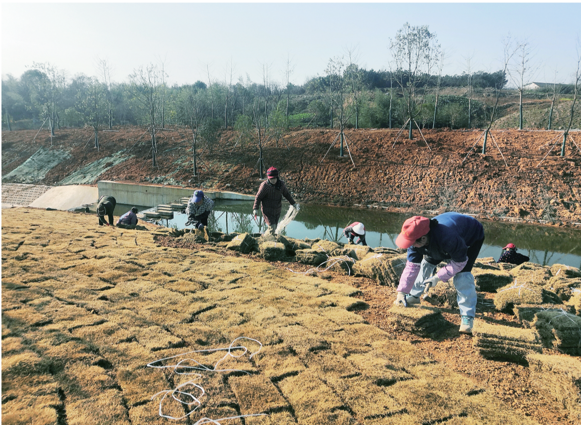
梅溪河综合整治工程起于市区环山路、梅溪路,终于宛溪河入河口。本次整治总长度4.66公里,建设内容包括:水利工程、截污工程、水生态修复工程、桥涵工程和景观工程。目前,正在进行河道上游绿化地形整理及苗木栽植、景观工程等工作,截至目前已完成工程量60%。
