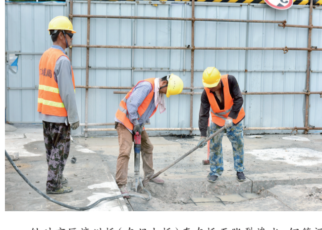
针对市区济川桥(东门大桥)存在桥面胀裂渗水、钢筋裸露锈蚀、护栏混凝土风化等安全隐患,为保障行人通行安全,近日,市城管执法局利用晴好天气,抓紧时间开展济川桥修复工程。该工程于8月8日启动,总投资225万元,预计工期4个月,本次维修改造工程内容包括桥面结构铺装层拆除、人行道挑梁板及护栏拆除、拱圈石墩墩裂缝修补、桥河护底铺砌、新建桥面系各项设施。(周萍 摄)
