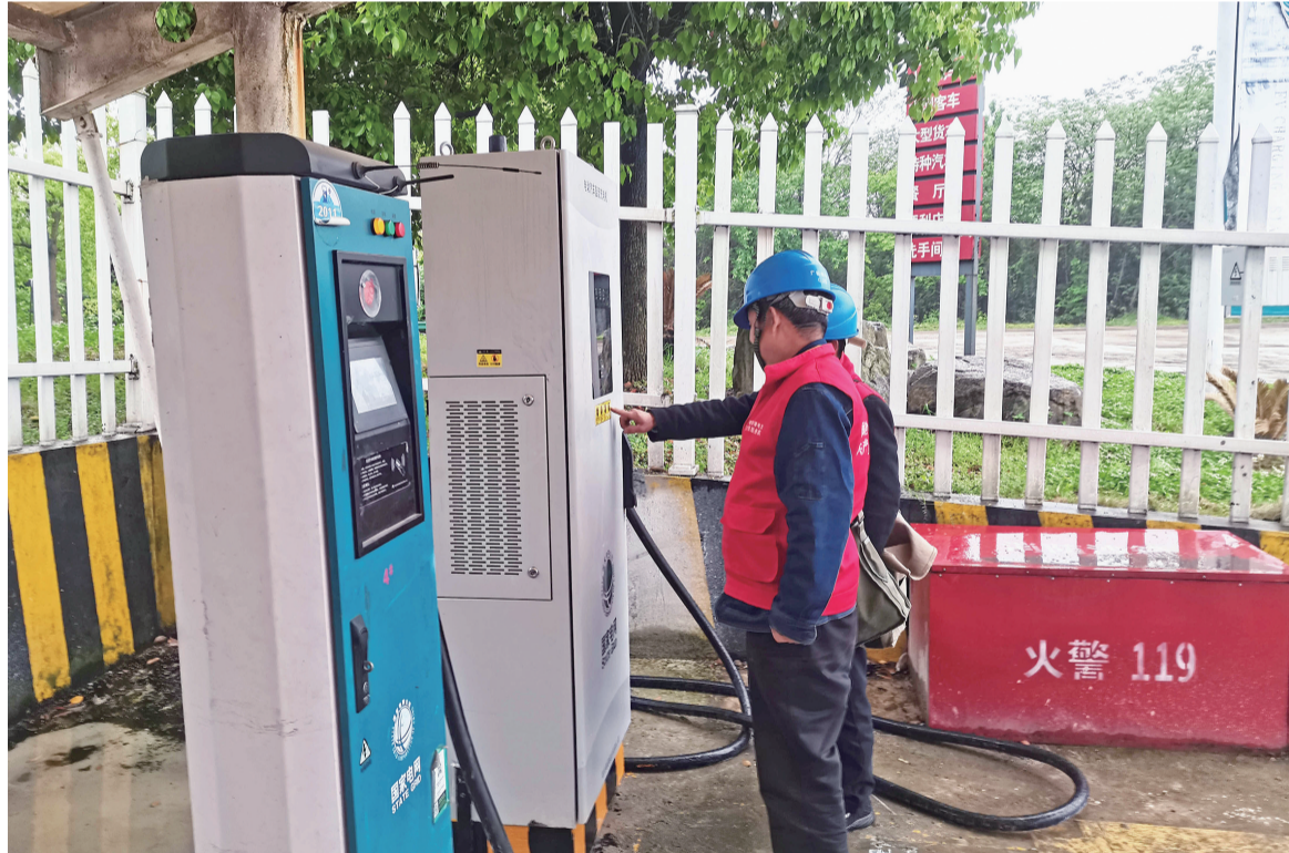
为做好“五一”小长假期间用电保障工作,自4月中旬起,国网广德市供电公司组织党员服务队到各景区及周边民宿,开展节前安全检查工作,及时消除安全隐患。与此同时,该公司还积极向当地经营者及周边村民宣传电力设施保护安全知识,全力当好助推旅游经济发展的“排头兵”。程梦原 摄
