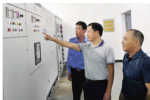
近日,我市普降强降雨。市防汛部门认真贯彻落实市防指防汛工作部署,狠抓排涝设备检修,确保汛期各排涝站及时有效排涝防洪,保障市民通行安全。目前市区各排涝站均检修完毕,设备运转良好,市区未出现内涝和道路积水现象。图为市区别士桥排涝站技术人员正在检查设备运转情况。张林 周萍 摄
