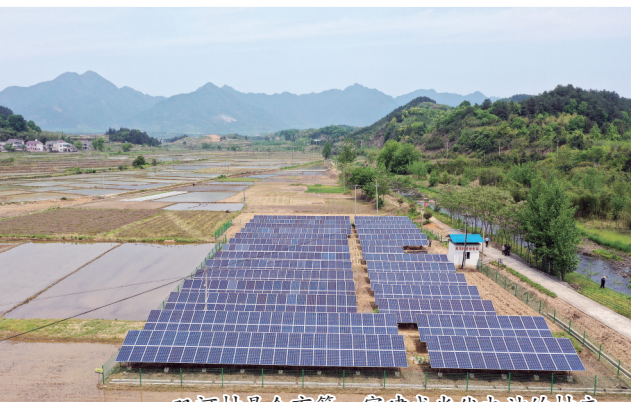
双河村是全市第一家建成光伏电站的村庄。
