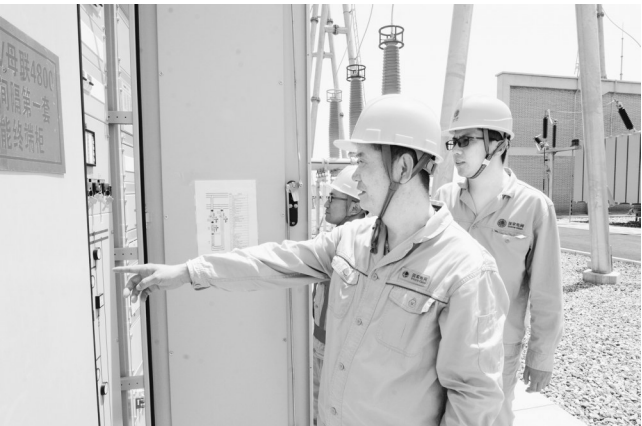
日前,郎溪县220千伏宗汉岭变电站成功投运。该变电站为郎溪县首座220千伏GIS变电站,也是宣城电网2019年迎峰度夏重点项目。除此之外,该变电站作为220千伏十字铺牵引站的电源点,也为明年开通的商合杭高铁运行提供可靠用电保障。
